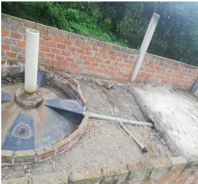
Figura 11. Cámara de digestión de excremento.
