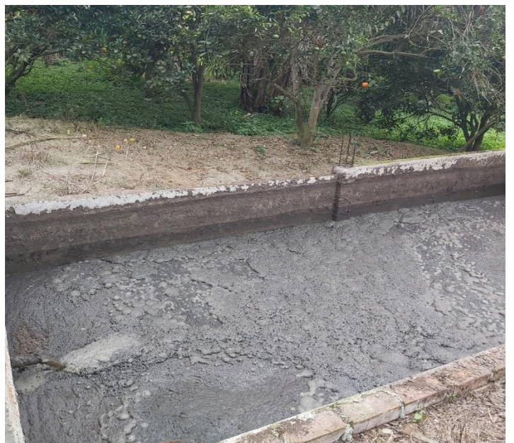
Figura 12. Salida de líquido de la cámara de digestión.
