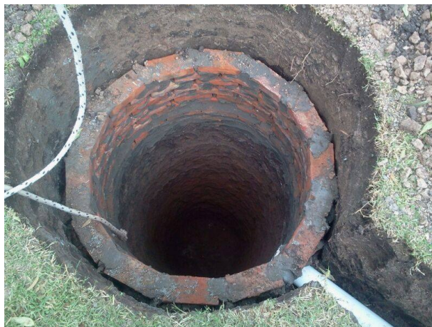
Ilustración 4. Pozo séptico (similar a los usados en San Carlos). Fuente: [4]
