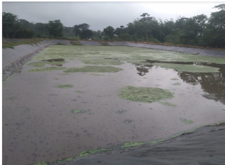
Ilustración 10. Laguna de estabilización de la planta de tratamiento de aguas residuales del Recinto San Carlos. Fuente: Elaboración Propia.
