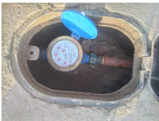
Ilustración 13. Medidores del Recinto San Carlos. Fuente: Elaboración Propia.
