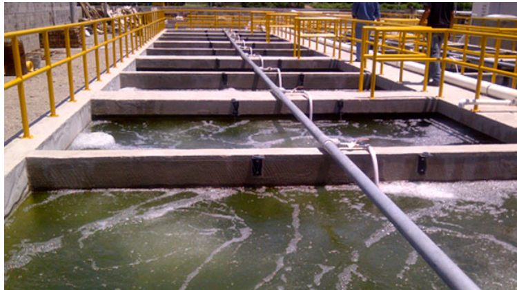
Ilustración 1. Planta de tratamiento de aguas residuales. Fuente: [1]
