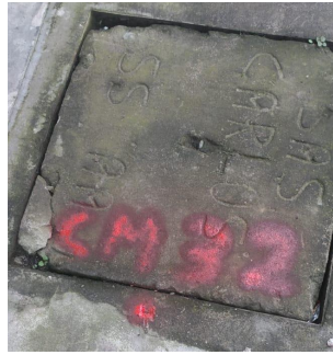
Ilustración 16. Tapa de caja domiciliaria. Fuente: Elaboración propia.
