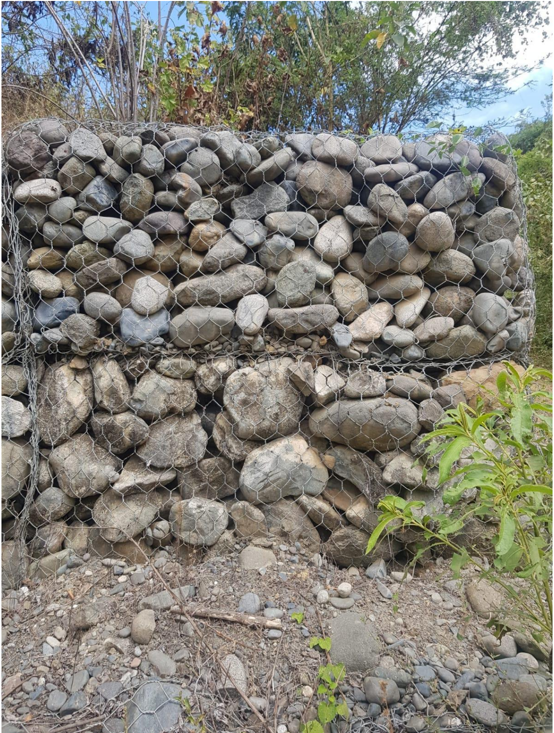
Anexo 6 Sistema de protección tipo gaviones en ambas márgenes de la quebrada El Toro
