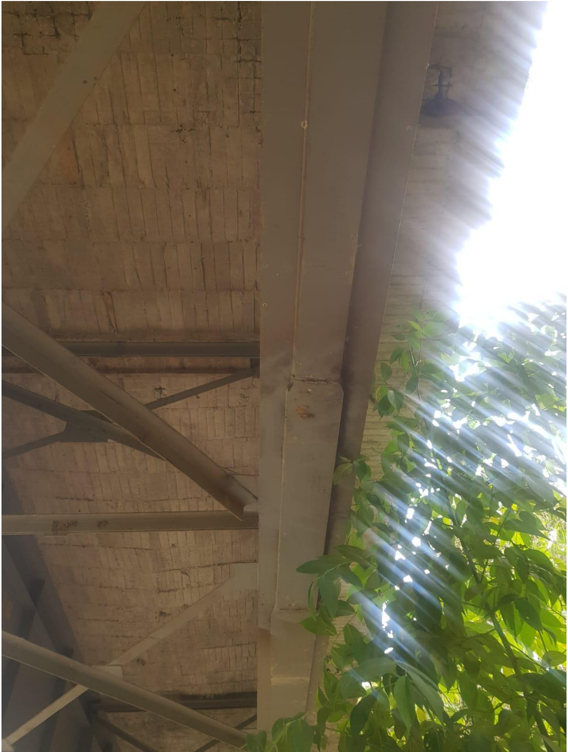
Anexo 10 Detalle del refuerzo en el patín inferior de las vigas de acero colocados en el puente
