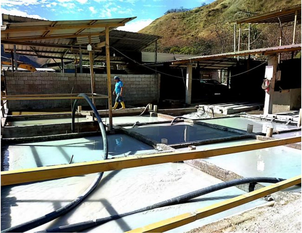
Ilustración 10. Piscinas de sedimentación. Recirculación de agua
