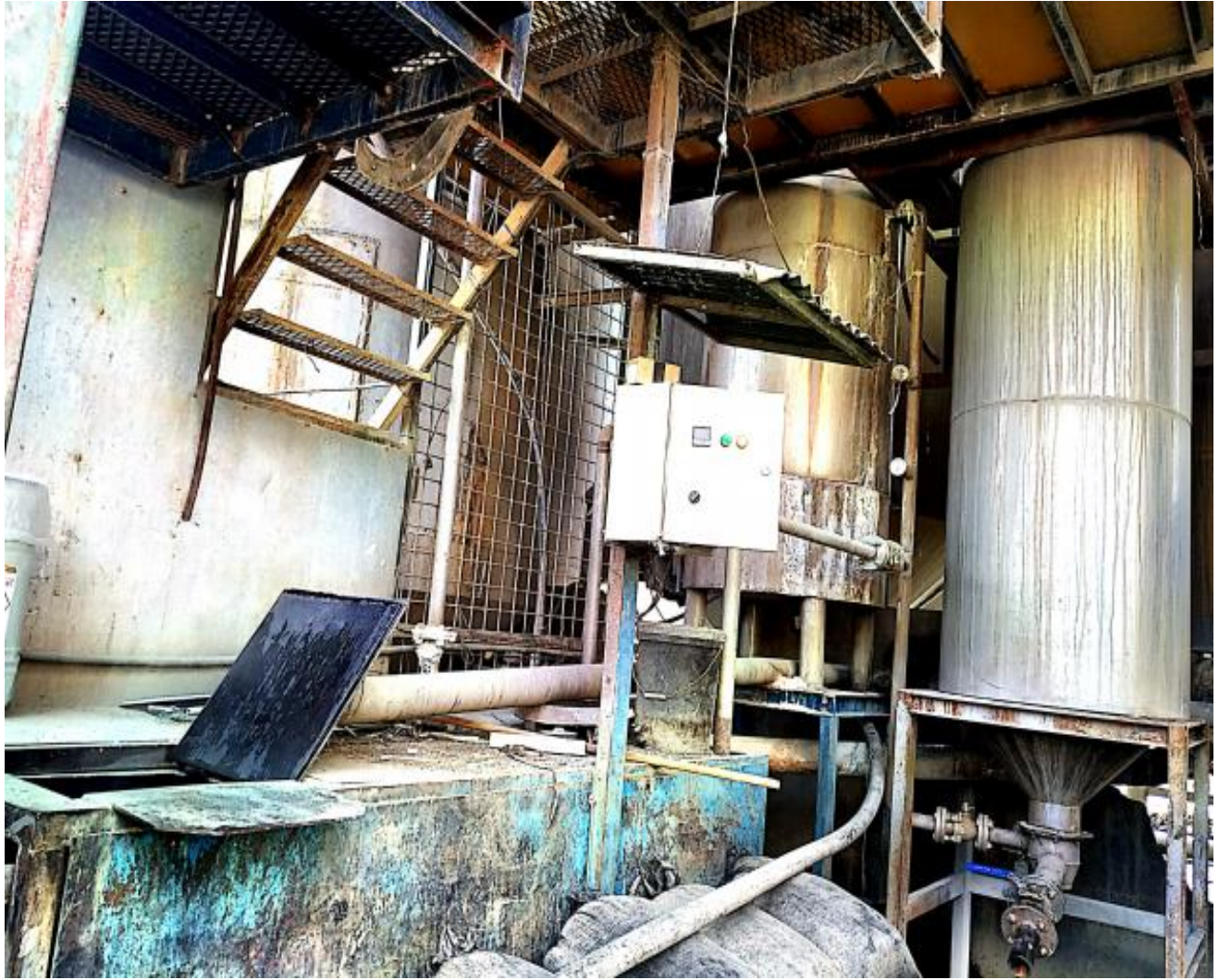
Ilustración 15. Celdas de elución con su respectivo tanque de almacenamiento de agua para la recirculación
