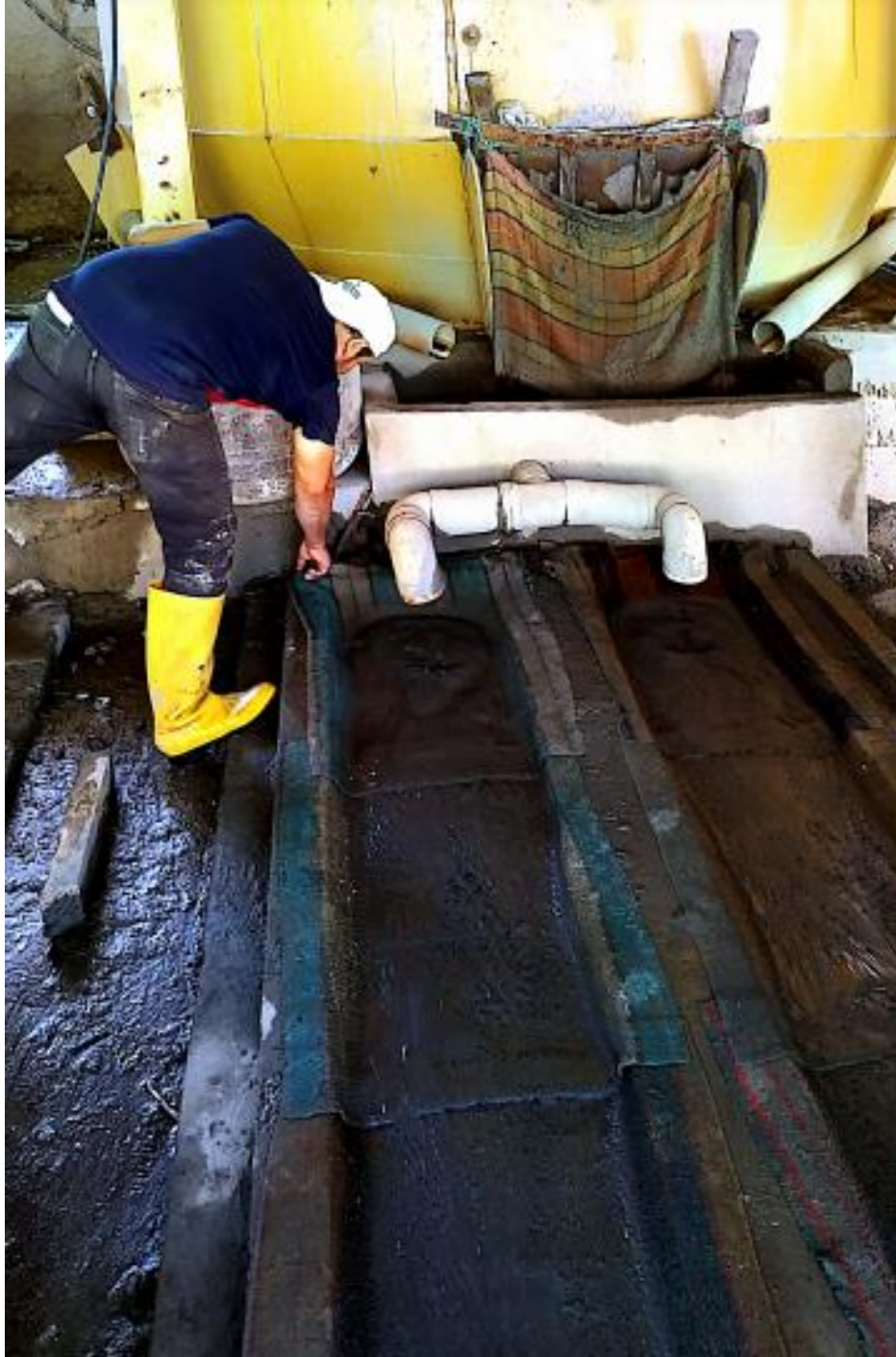
Ilustración 8. Canalones con sus respectivas balletas
