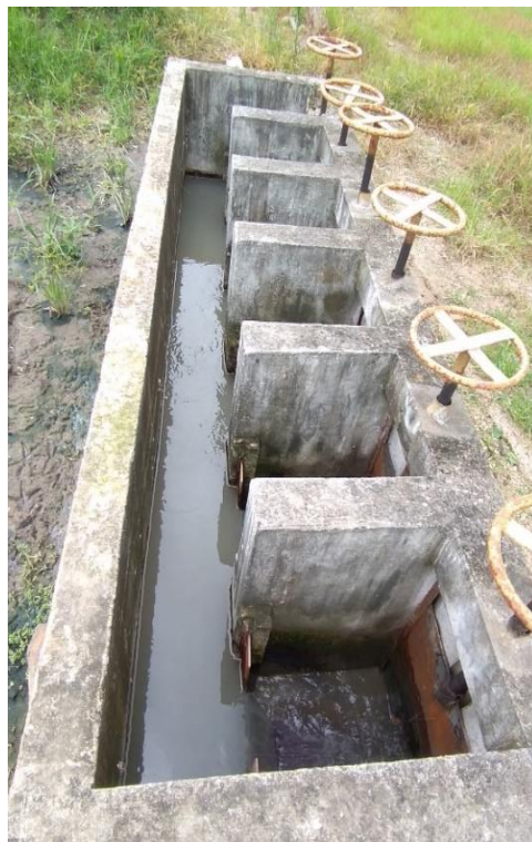
Figura 6. Cajón repartidor de caudales
