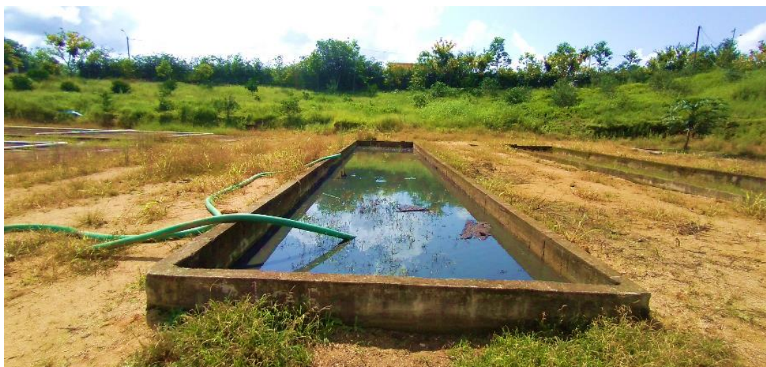
Figura 10. Lecho de Secado de Lodos
