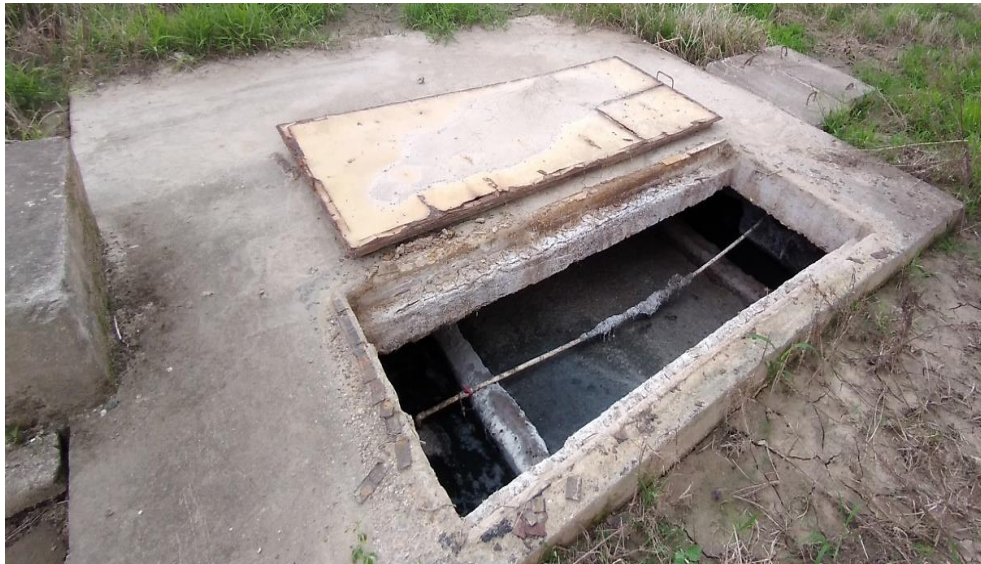
Figura 8. Cámara de desinfección
