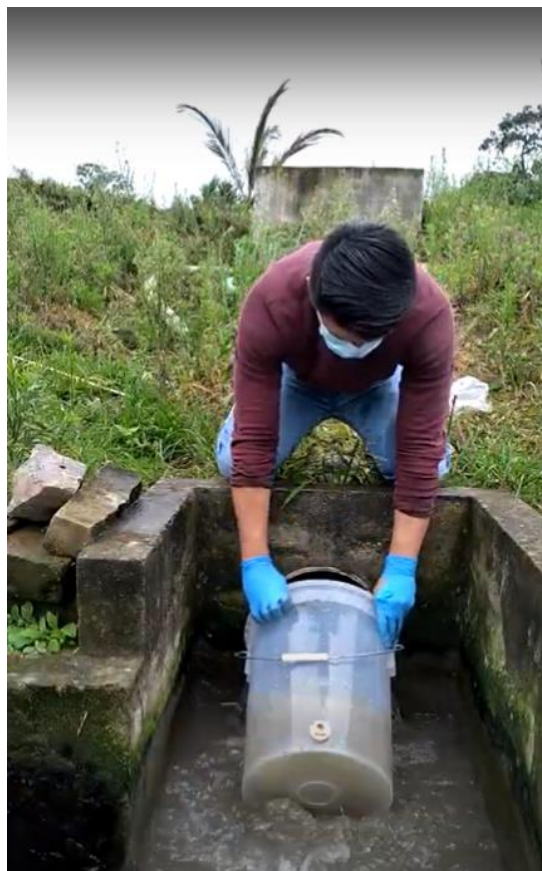
Figura 14. Aforo del caudal que ingresa a la planta (método volumétrico)
