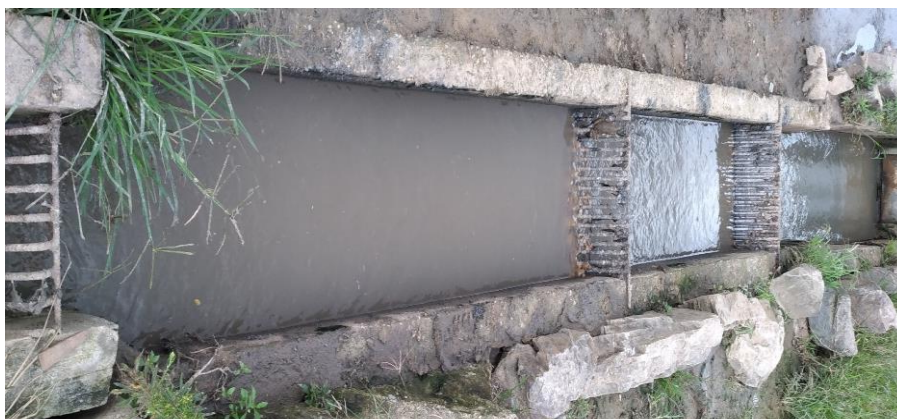
Figura 4. Canal desarenador y cribado fino
