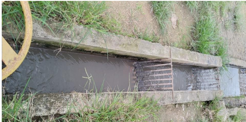
Figura 3. Canal de entrada y cribado grueso
