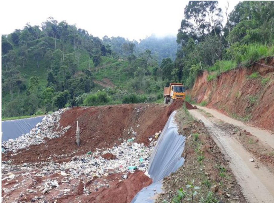
Ilustración 26. Vista de Celda en Funcionamiento
