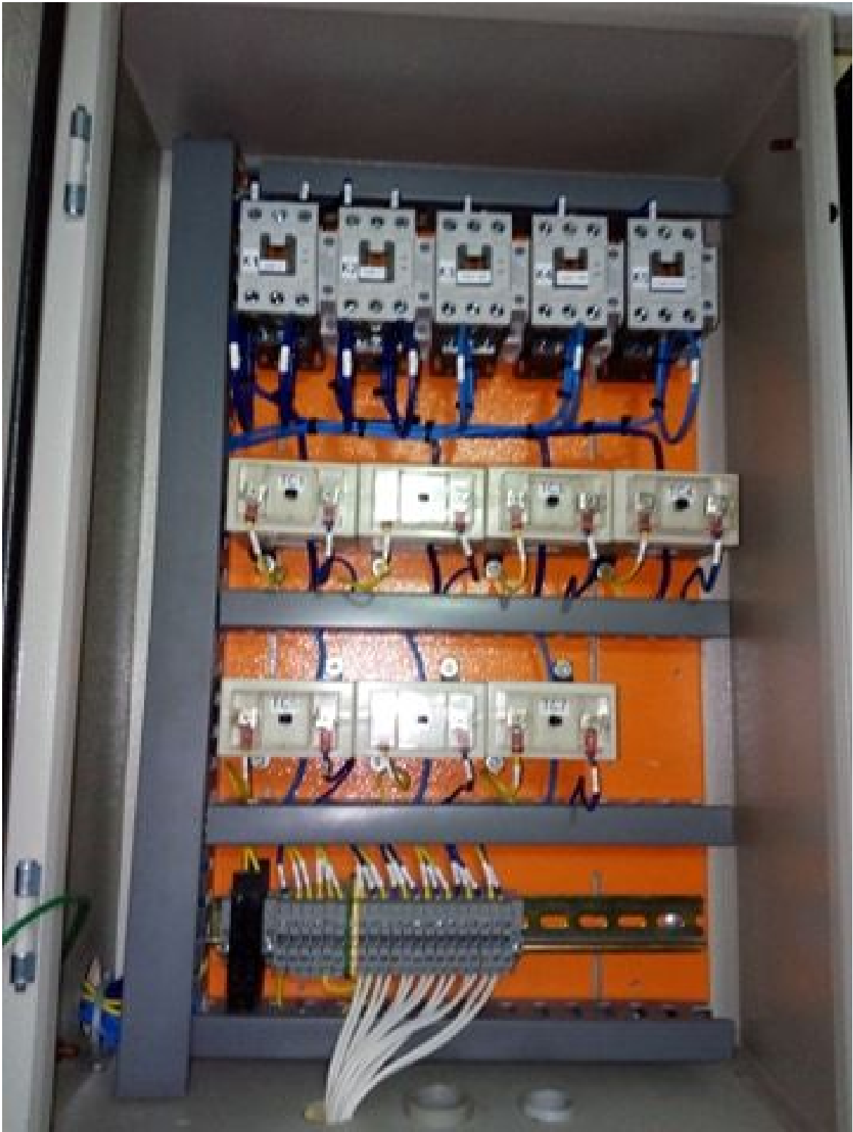
Anexo 20: Tablero de recolección de variables eléctricas
