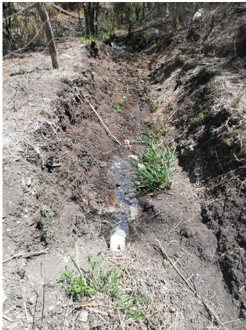
Ilustración 10: Conducción de lixiviados al aire libre.
