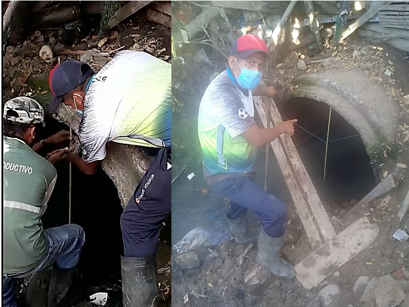
Anexo 4. Colocación de dispositivo manual para medición de tirante en el colector.
