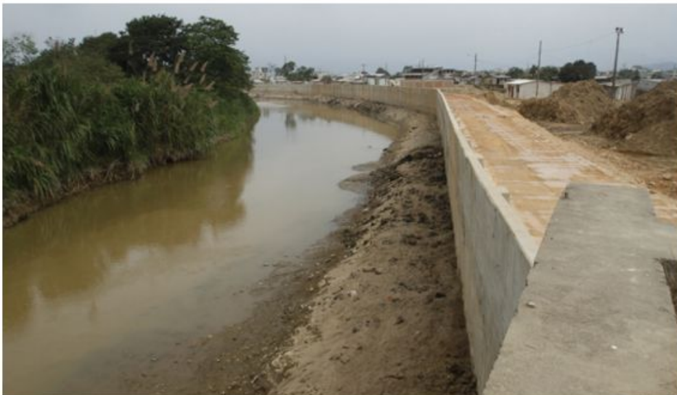
Anexo 3. Muro de Contención para enfrentar Inundaciones en el Cantón Santa Rosa. 19/01/2016. En El Comercio por FLORES, Francisco.
