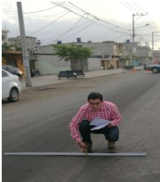
Fig. 23 Ahuellamiento Fuente: El autor.
