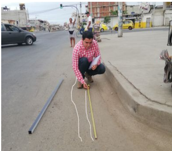
Fig. 18 Grietas de borde Fuente: El autor.
