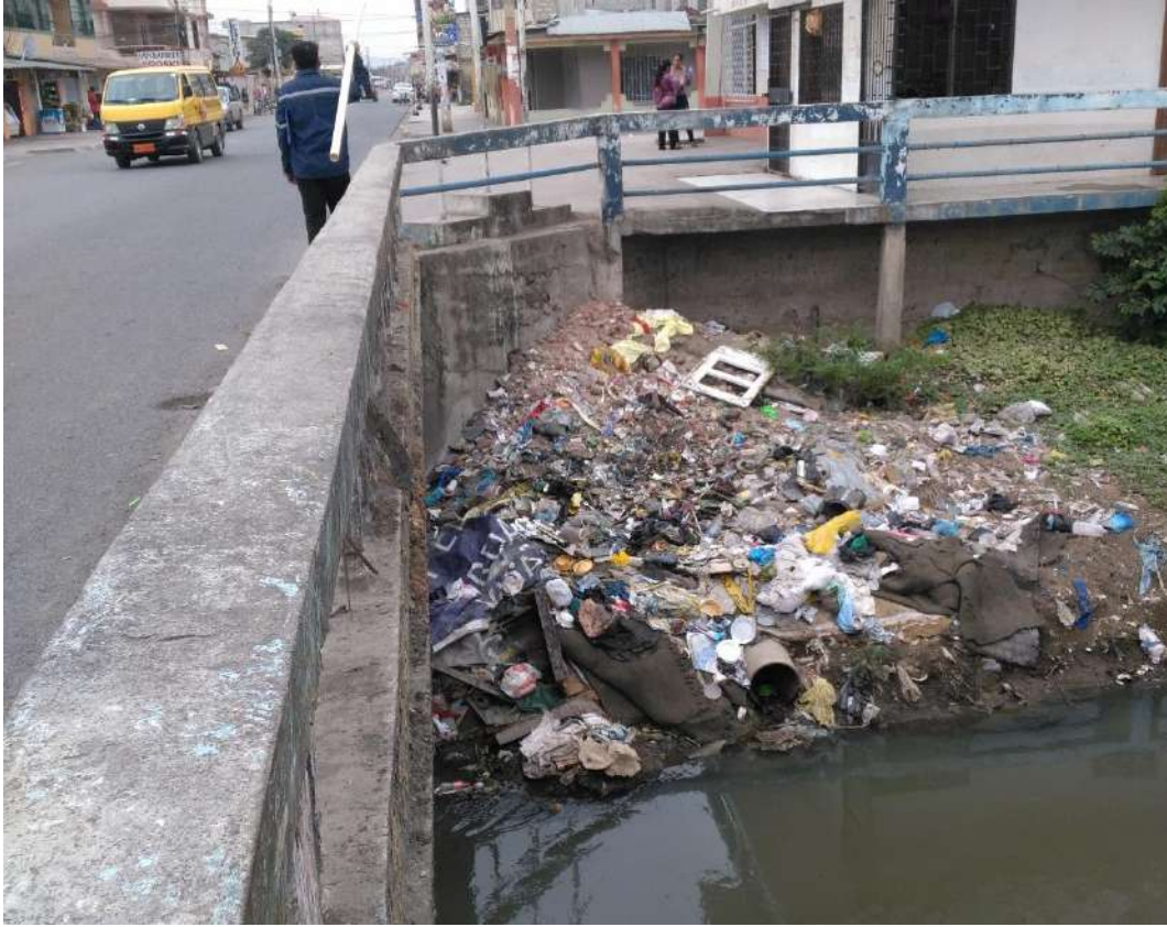
TF 13. Contaminación del canal El Macho en la zona urbana.
