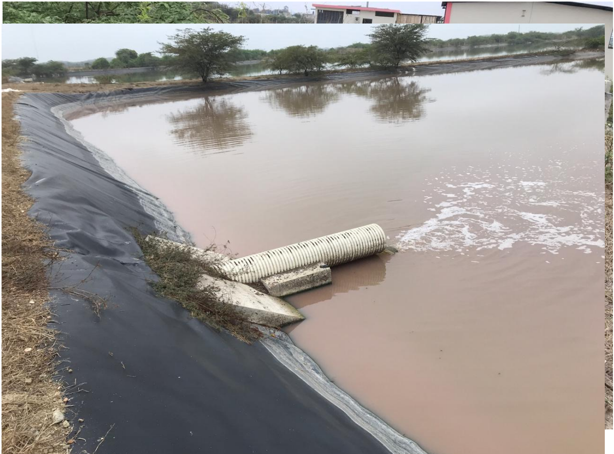
ANEXO 6: Entrada del agua residual a la primera Laguna Facultativa
