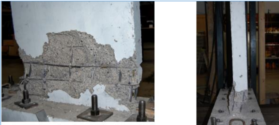
Ilustración 3. Fallas por compresión y pandeo fuera del plano. Fuente: Hube y J.C de la Llera
