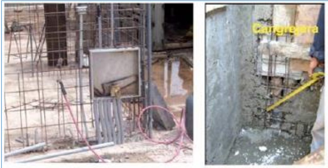
Ilustración 5. Defectos ocasionados por congestión de refuerzo, falla por cangrejeras en los talones de los muros. Fuente: Bartolomé y Ríos.
