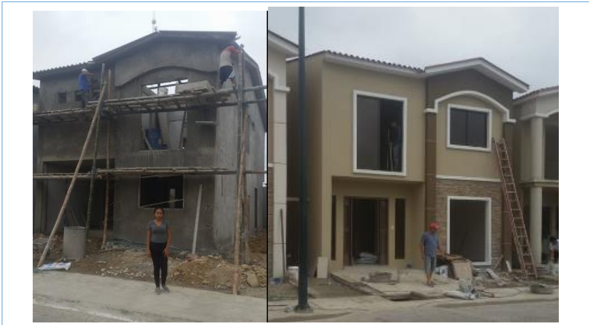
Ilustración 18. Vivienda tipo de dos pisos con el sistemas de ductilidad limitada - caso pórticos resistentes a momento. Fuente: Autor de este documento
