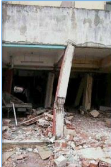
Ilustración 8. Falla de flexión en columnas. Fuente: Gálvez, 2017
