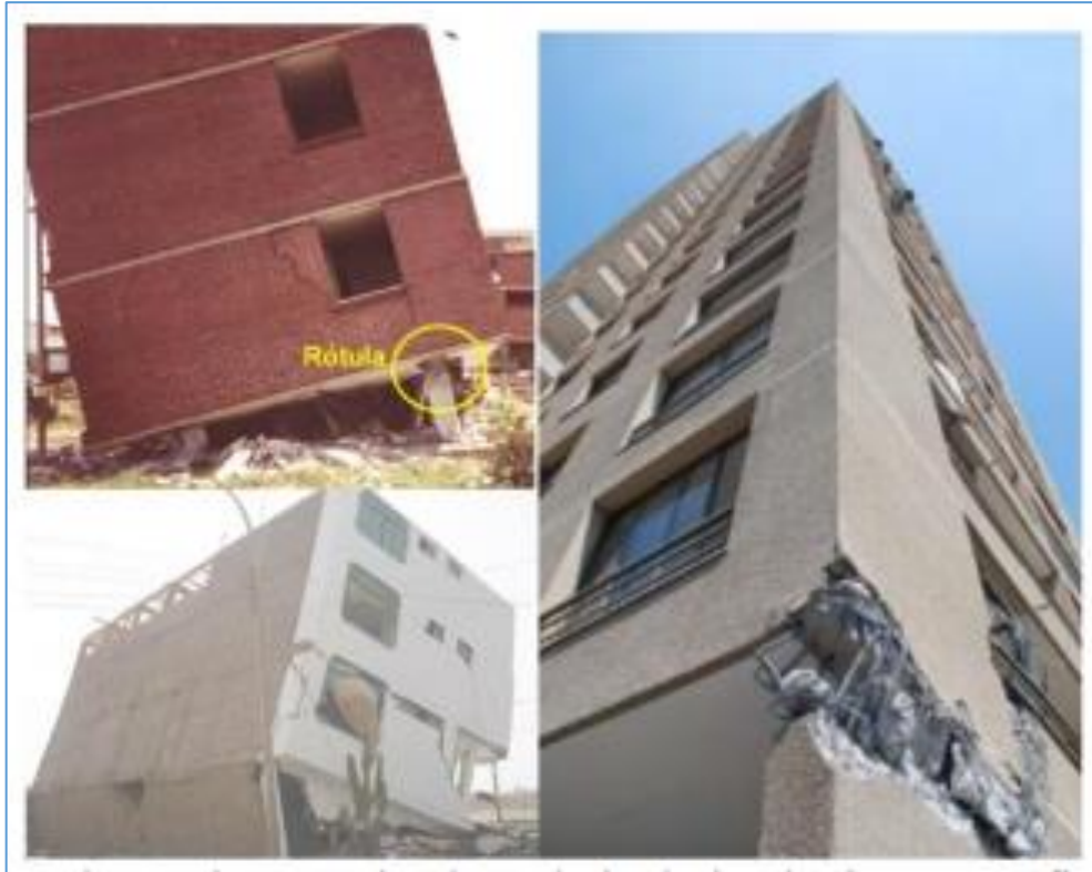
Ilustración 9. Falla estructural en columnas de planta baja derivado de una configuración de piso suave. Fuente: Aguilar, 2010
