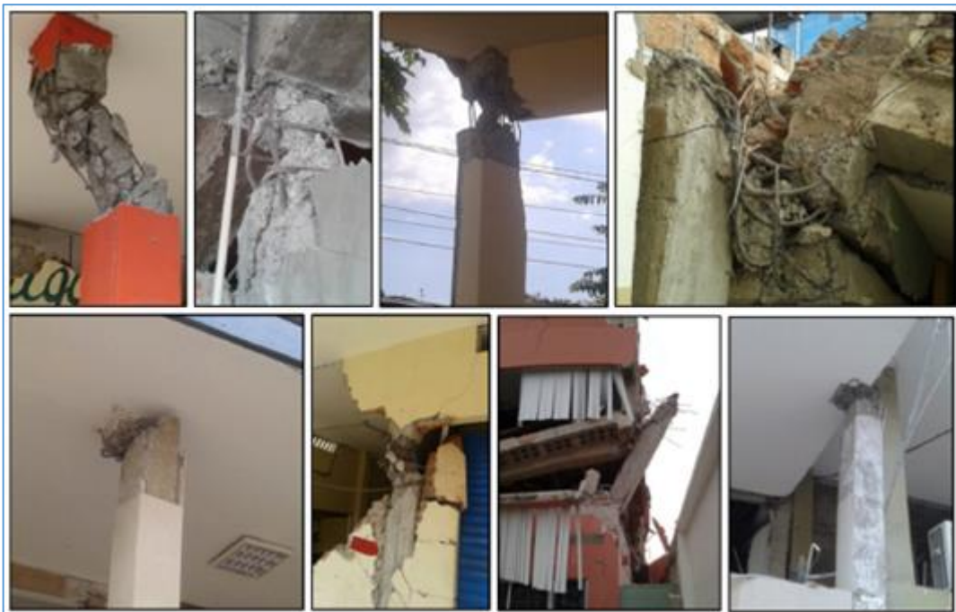
Ilustración 10. Edificaciones de la ciudad de Portoviejo que muestran fallos por corte y por confinamiento en columnas. Fuente: Castañeda y Bravo
