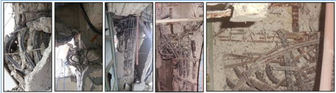
Ilustración 15. Irregularidades de construcción fallas por flexo-compresión en columnas. Fuente: Castañeda y Mielles
