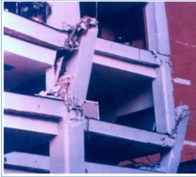
Ilustración 14. Falla en la conexión viga-columna. Fuente: Dulce García
