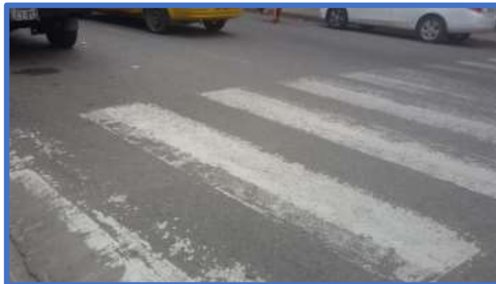
Gráfico 3. Señales horizontales en mal estado
