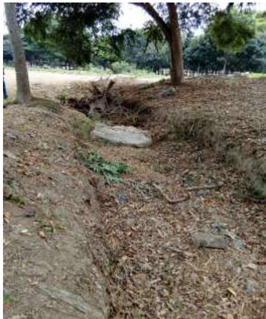
Ilustración N° 15.- Antiguo canal destinado para ejecución de la segunda alternativa. Fuente: El Autor, 2018.
