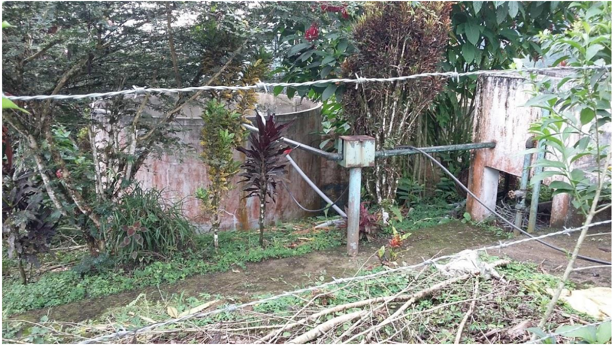
Filtro lento con un diámetro de 3.80 m y con un área de filtración de 22.46\text{m}^2
