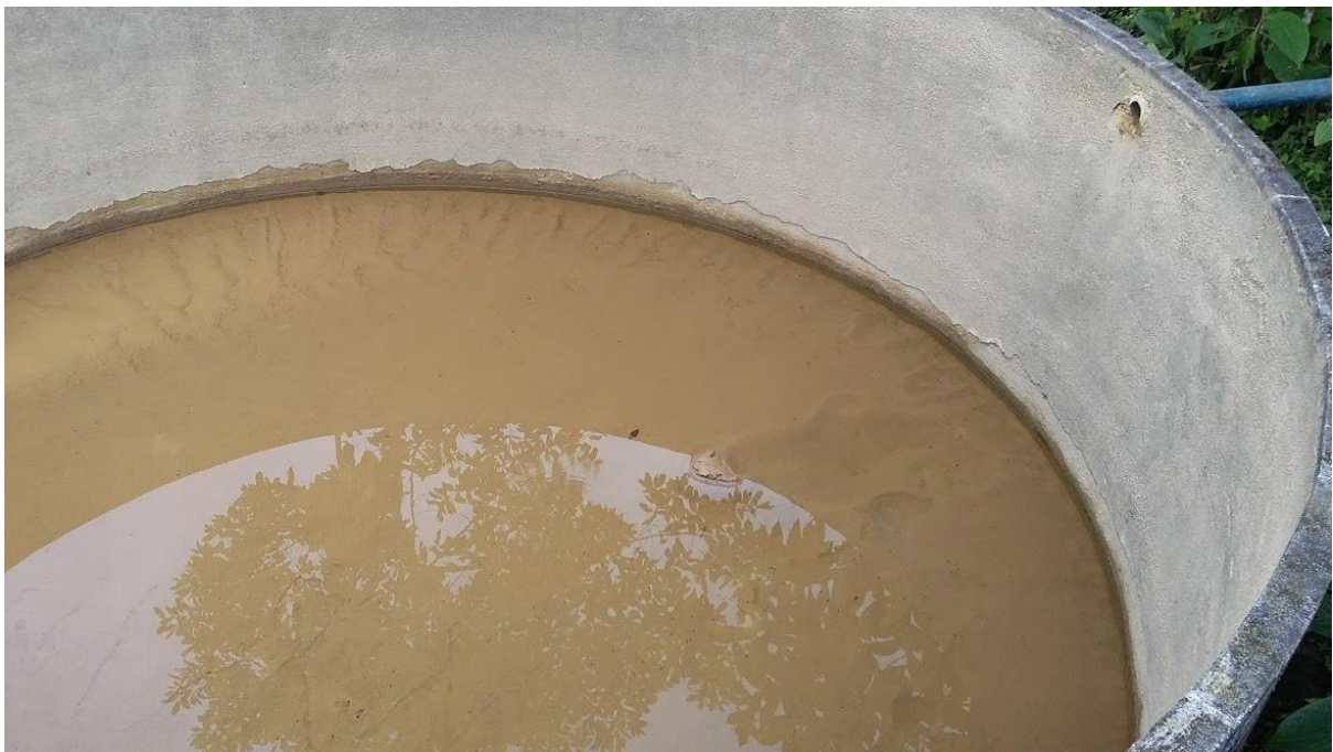
Filtro lento que no está en funcionamiento por falta de mantenimiento.
