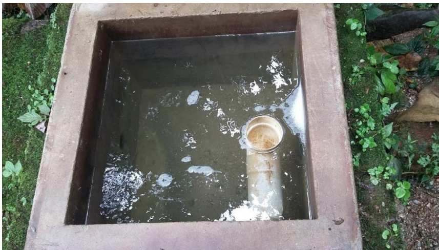
Desarenador ubicado a 30 m de distancia después de la captación.
